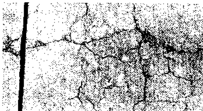
Photo 1 : Fissure de retrait plastique dans le béton
